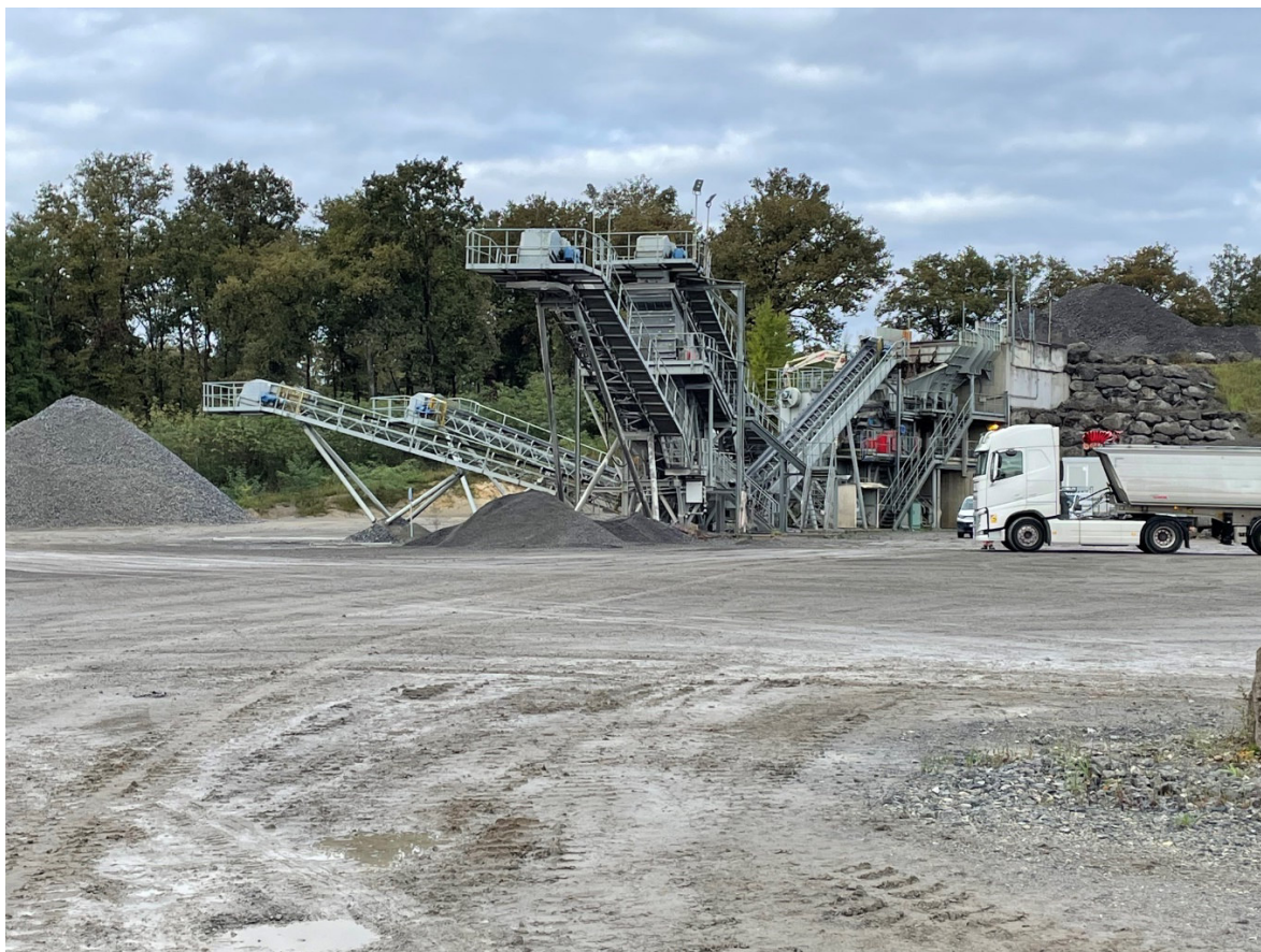
Photo 5 : Installation de broyage des vieux bétons pour recyclage en granulats
